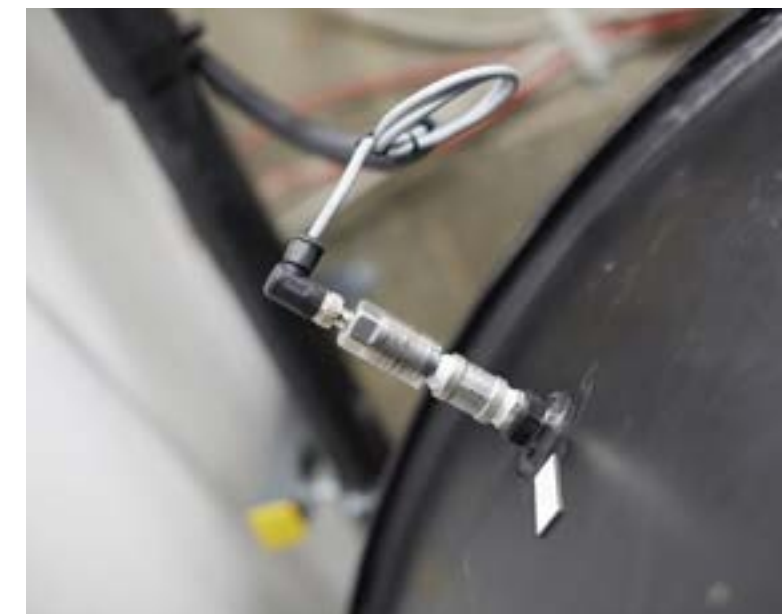
Le capteur intégré surveille le remplissage de la cuve
